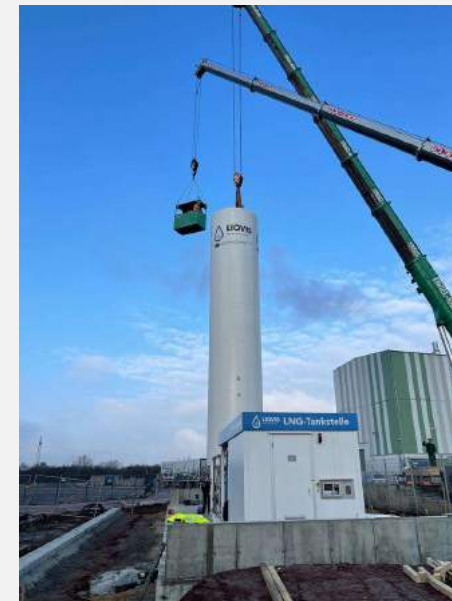
LNG Liqvis/Uniper auf dem IGP Mittelbe 2022
